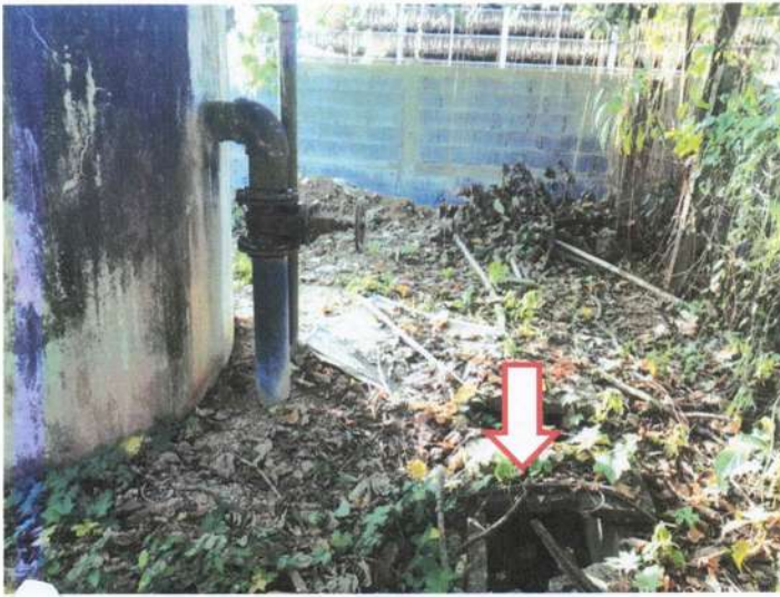
แนวรางระบายน้ำทิ้งระบบประปา
